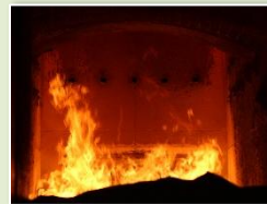
CERNAY ENERGIES ENVIRONNEMENT foyer à grilles – 4,2 MW
