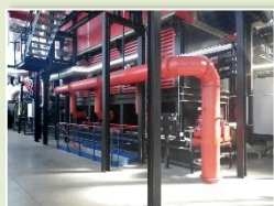
MULHOUSE ILLBERG 2 foyers à grilles - 8 + 4 MW
