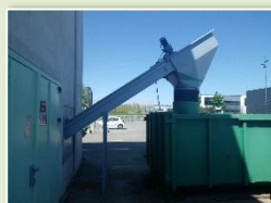
RIXHEIM VALORIM foyer à grilles – 2,8 MW
