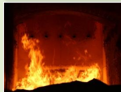
CERNAY ENERGIES ENVIRONNEMENT foyer à grilles – 4,2 MW
