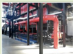
MULHOUSE ILLBERG 2 foyers à grilles - 8 + 4 MW
